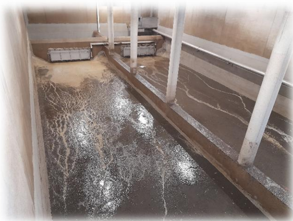
Bassin de stockage restitution
