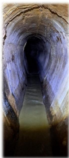
Sury-le-Comtal – collecteur dégradé
