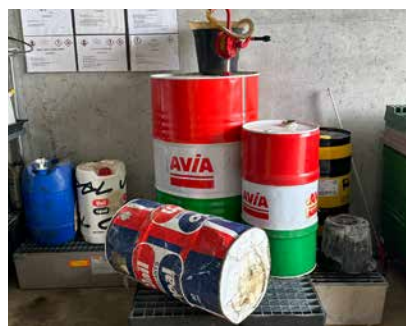
Rétention insuffisante et risque de pollution.
